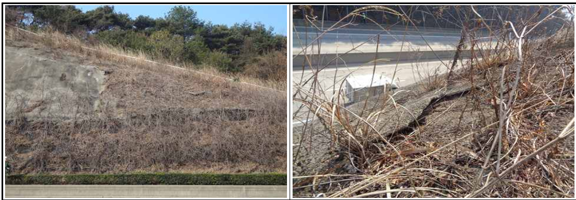
① 66.94K 1단 상부 슛크리트 들뜸 및 파손 ⇨ 낙석방지망 (A=20*12)
